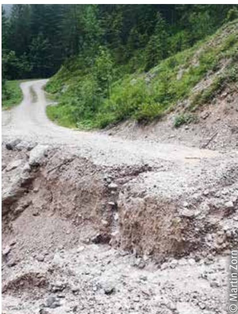
Schäden durch Gewitterregen an der Brucksattelstraße im Bereich Kühgraben
